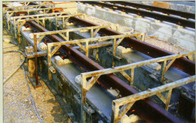
Kurz nach dem Betonieren der Längsbalken: Erkennbar ein Justierportal, Schalung mit Haltern und die speziellen Schienentragkörper. Aufnahme: SG
